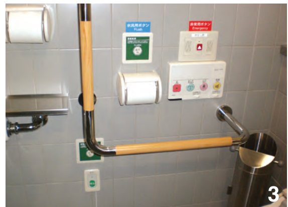
JIS規格に沿った配置をしているトイレ操作盤
